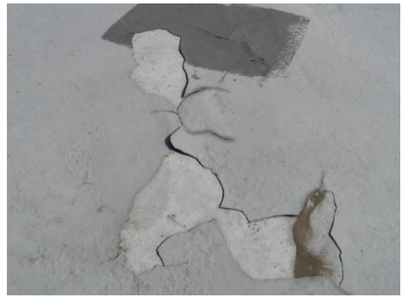
写真 2.1.2 防水層の破損の事例
