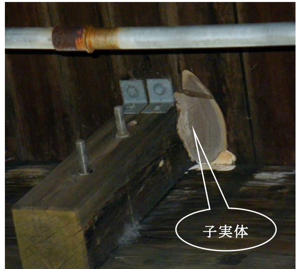
写真 2.2.6 木材腐朽菌の子実体の事例
